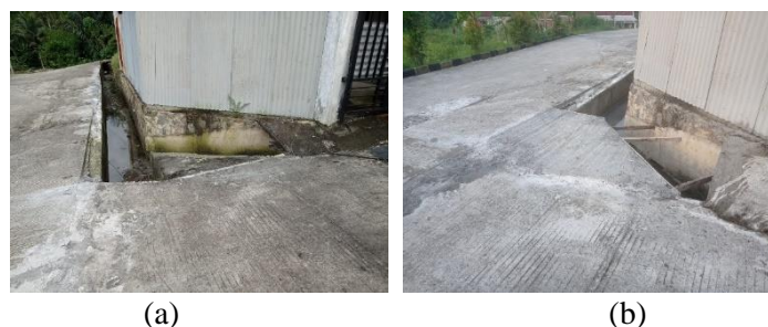
Gambar 13. udut Pertemuan Jalan Walisongo 1 dengan Jalan Walisongo; (a) Kondisi Awal; (b) Kondisi Setelah Kegiatan Pengabdian
