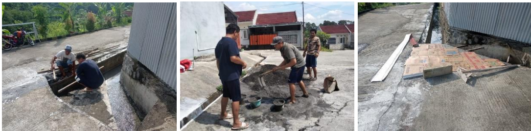
Gambar 9. Pekerjaan Tambahan Cor di Sudut Pertemuan Jalan Walisongo 1 dengan Jalan Walisongo 2 c) Pekerjaan Penerangan Jalan di Sudut Jl. Walisongo 4.
