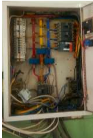
Gambar 5. MDP Gedung A
