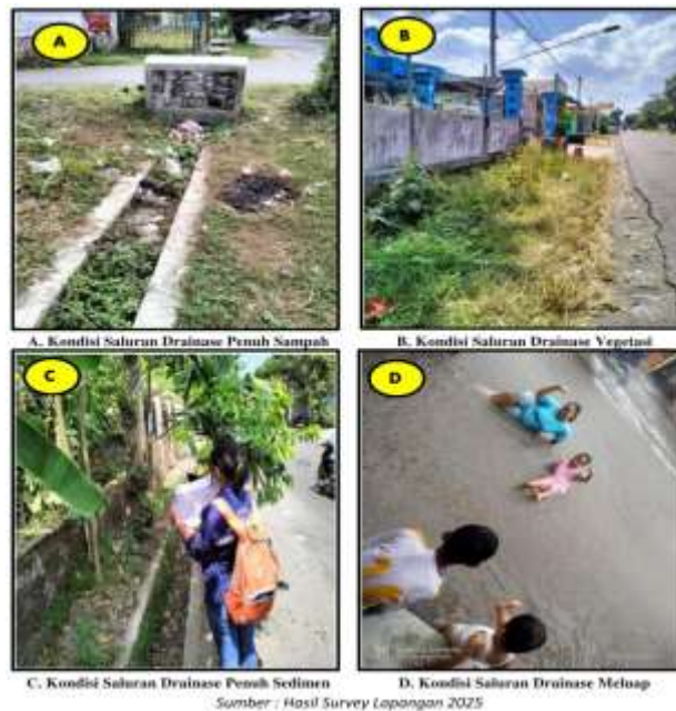
Gambar 2. Kondisi Eksisting Saluran Drainase
